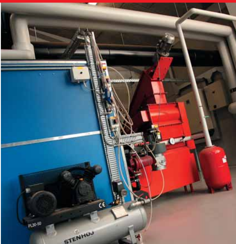
Verwarmingsinstallatie op houtspaanders
